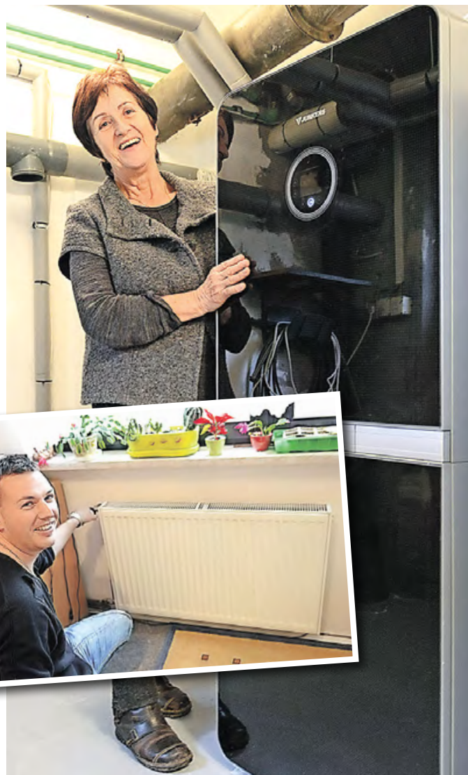
Irene Kunath strahlt wie ihr blitzsauberes Brennwertgerät; auch Sohn Stephan hat sichtlich Freude an der neuen Heizung. Fotos (2): SPREE-PR/Rasche
